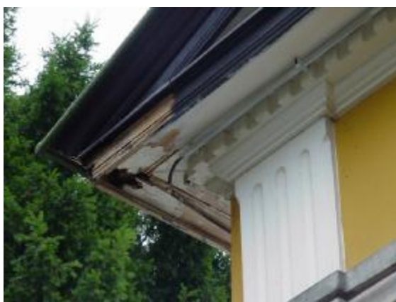
Achterstallig onderhoud aan het poortgebouw. In 2004 is het gebouw en de erf afscheiding gerestaureerd.
